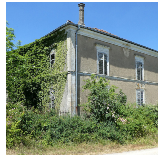
4. l' incidence d'une végétation abondante près de la maison entretenant une humidité constante en ralentissant l'évaporation de la pluie.
