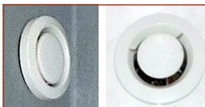
Propreté suspecte de bouches de ventilation
