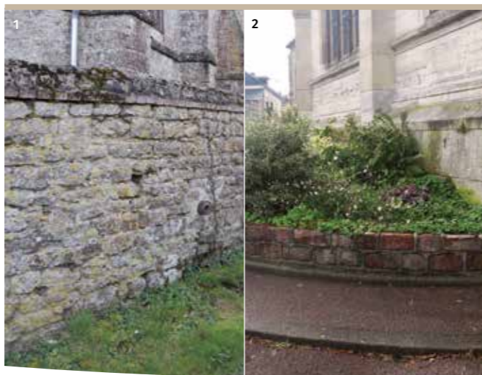
1 Joints du mur de soutènement de l'enclos paroissial creusés
